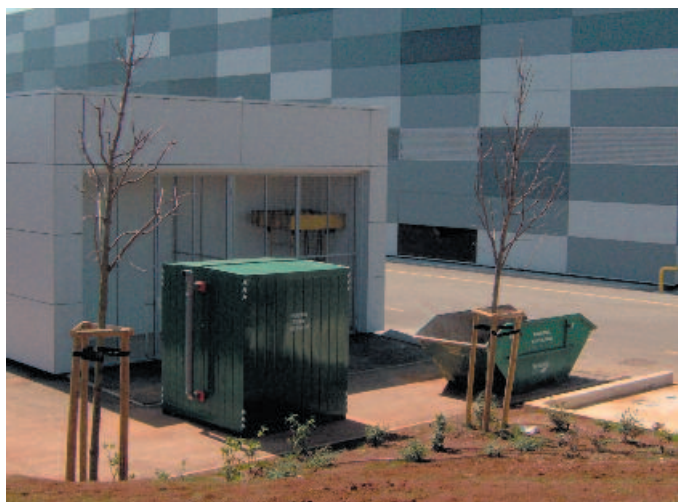
Spremište zapaljivih tekućina na lokaciji
