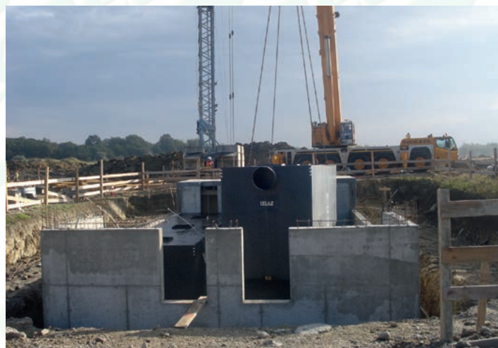
Ugradnja više separatora i rade zajedno kao jedan sustav
