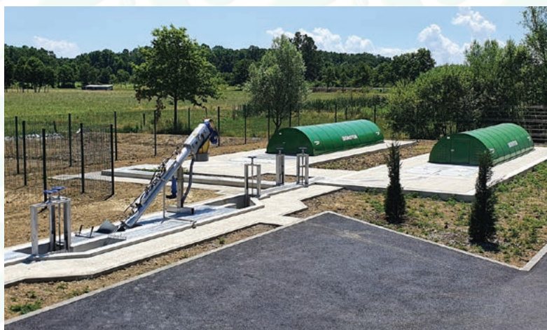
Uređaj za pročišćavanje otpadnih voda
