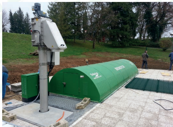
U sklopu kompleksa hotela - biorotor sa automatskim izvlačačem krutina
