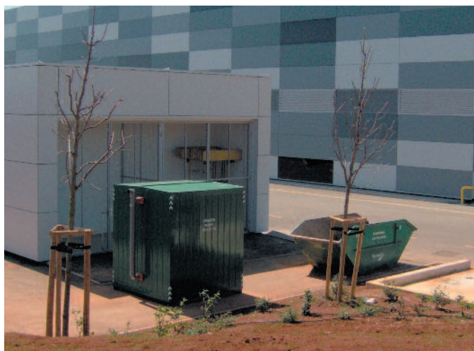
Spremište zapaljivih tekućina na lokaciji
